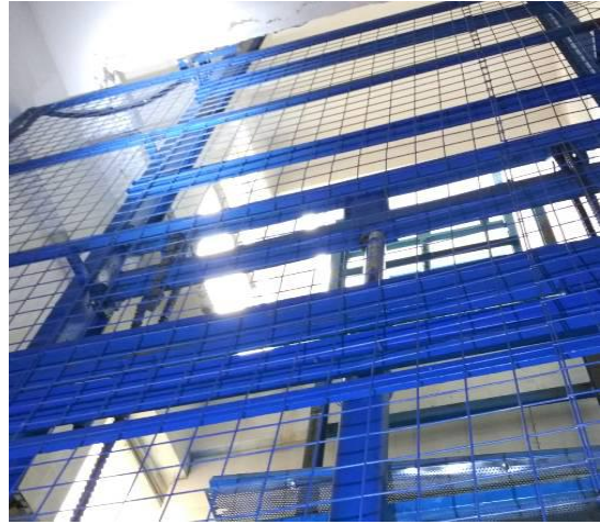
液压缸杆松脱
