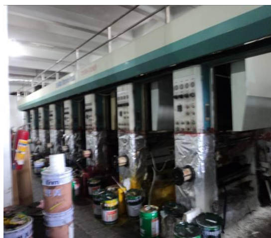
需方薄膜印刷生产线
