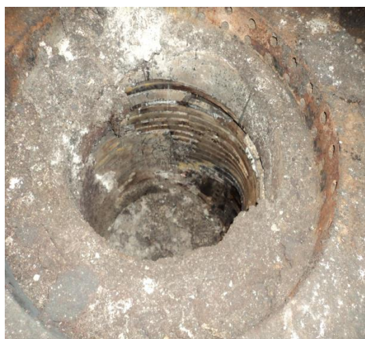
电炉破坏严重
