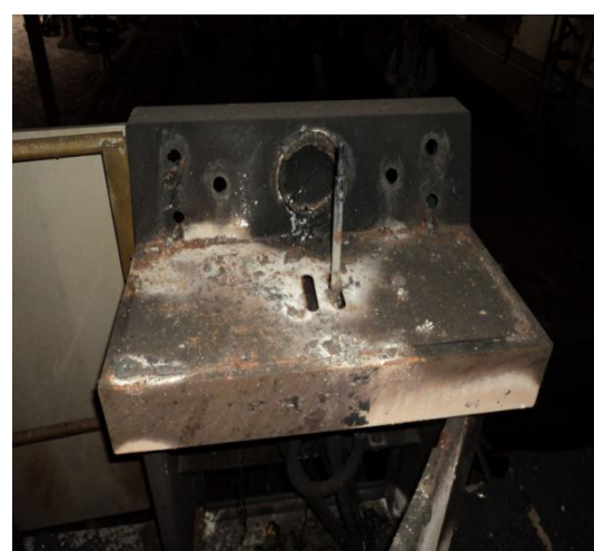
电炉操控台被烧毁
