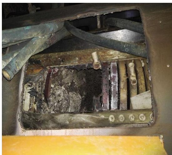
电炉右侧底部的破坏孔洞
