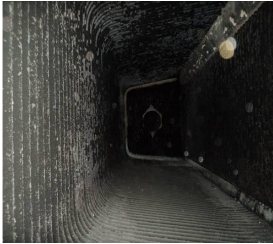
启动锅炉的炉膛内部
