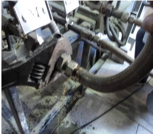
启动锅炉的柴油取样位置
