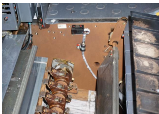
内部锈蚀状况
